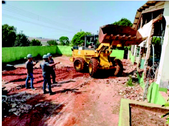
Os serviços foram iniciados na semana passada: melhorias no setor de educação
