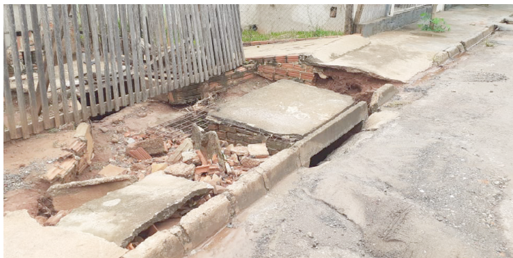
Na Rua Antonio Moulin, calçada chegou a ser quebrada com a força da água
