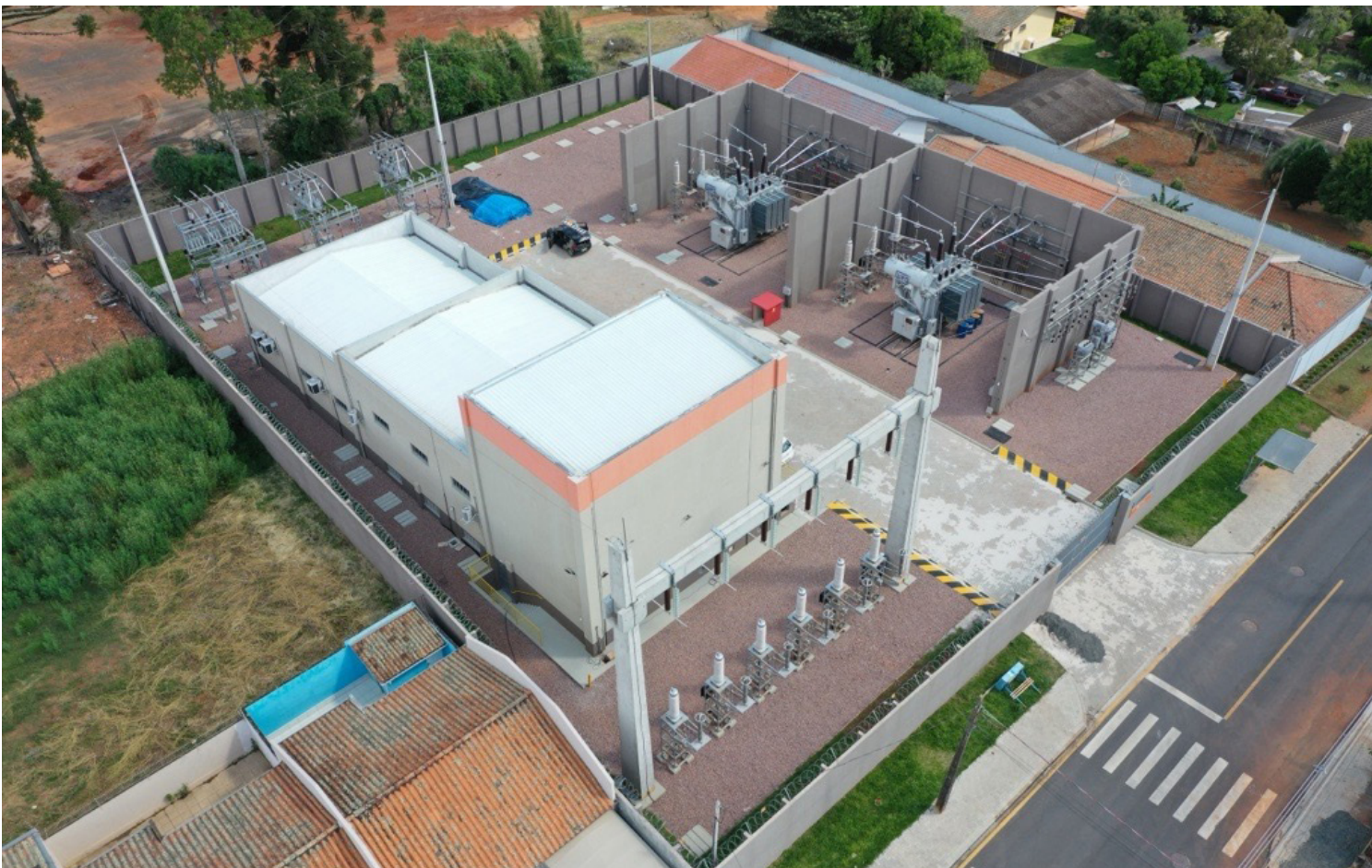
Montante integra os mais de R$ 2 bilhões que serão aplicados em obras de distribuição de energia em todo o Paraná ao longo do ano e vão reforçar a infraestrutura elétrica, além de contribuir para aumentar a qualidade do fornecimento de energia à população
