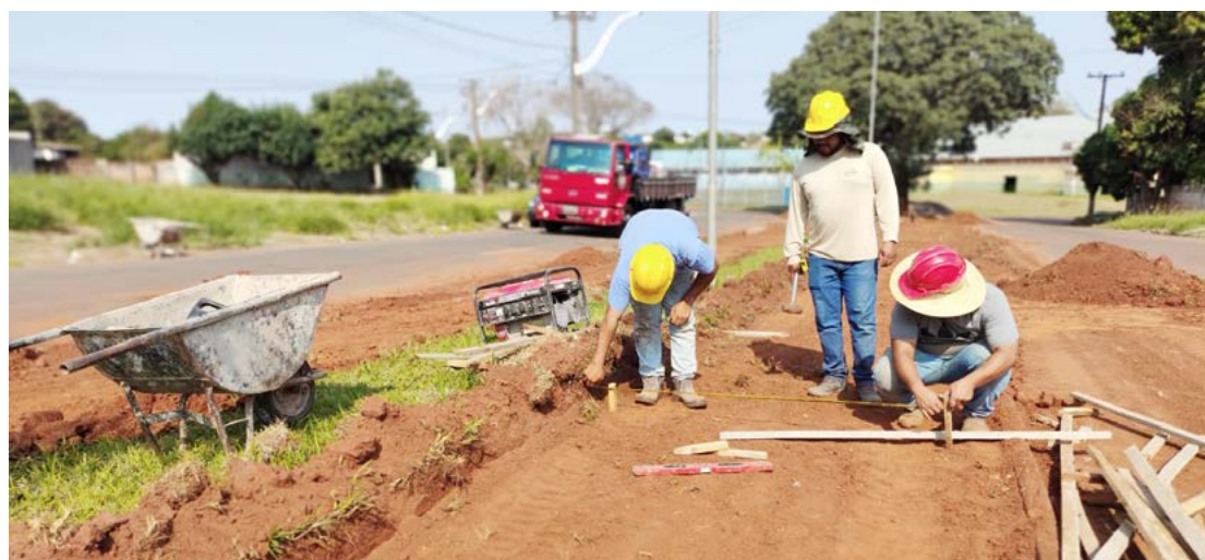
As obras vão contemplar toda a extensão da avenida Curitiba, principal via do bairro
