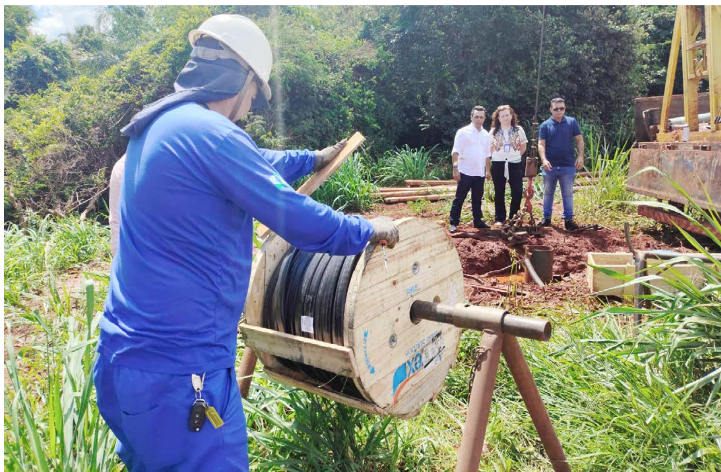
O prefeito Betinho Lima, o vereador 'Paraíba' e a gerente da Sanepar, Aracely, no local onde o novo poço foi perfurado
