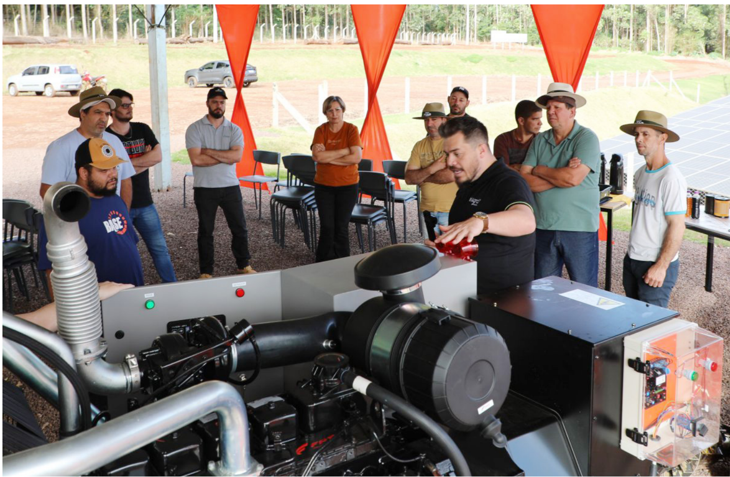
cooperados aprofundaram o conhecimento sobre o uso de geradores de energia, equipamento indispensável para garantir a segurança dos aviários
