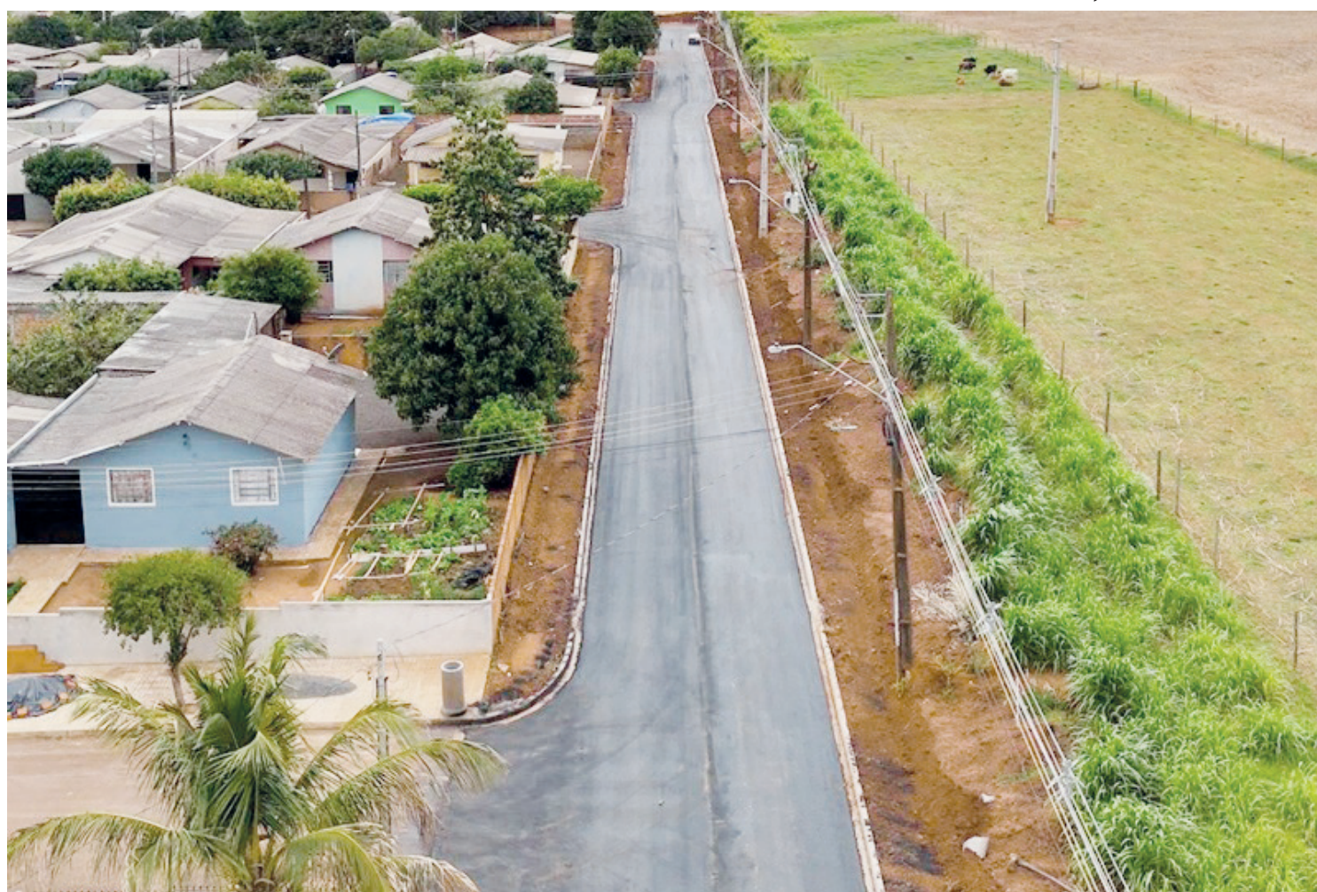
A empresa vencedora da licitação está concluindo as obras, que somam um investimento de R$ 4,3 milhões
