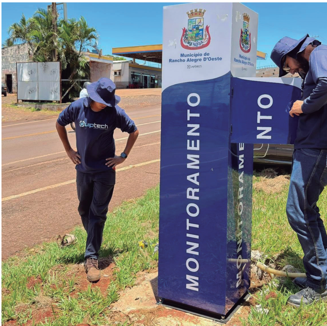
Os serviços de instalação foram iniciados nesta semana: em seguida as câmeras vão entrar em funcionamento
