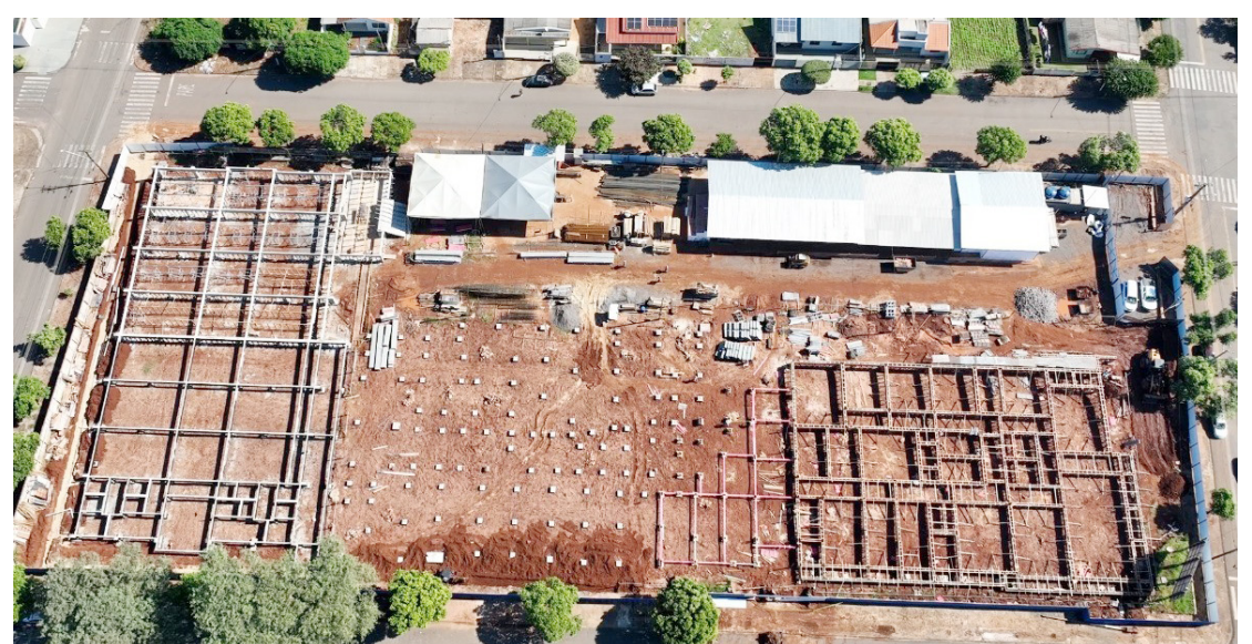
As obras de fundação entram na fase final: conquista importante para a cidade
